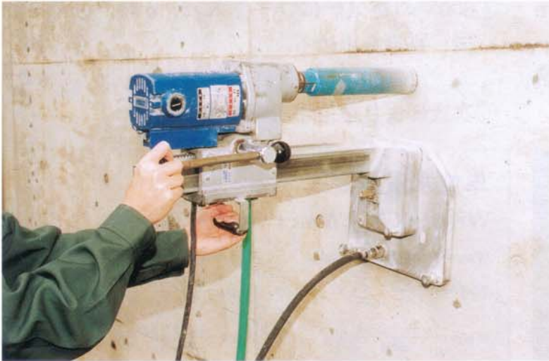
写真-1 コンクリートコアマシンによるφ50mmコア採取状況
