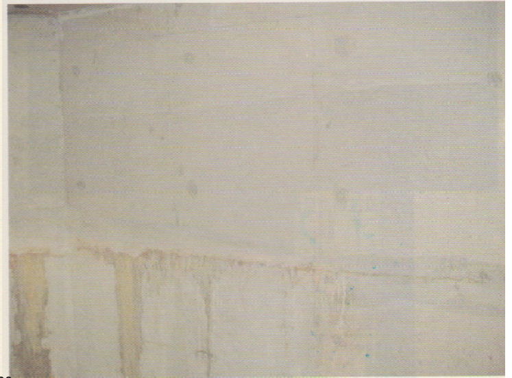
重度 (対応する補修は解説図-6.2.4 参照) コールドジョイントの例
