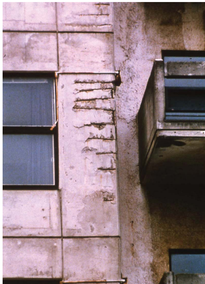
20年前に解体した本学の中性化による劣化建物
