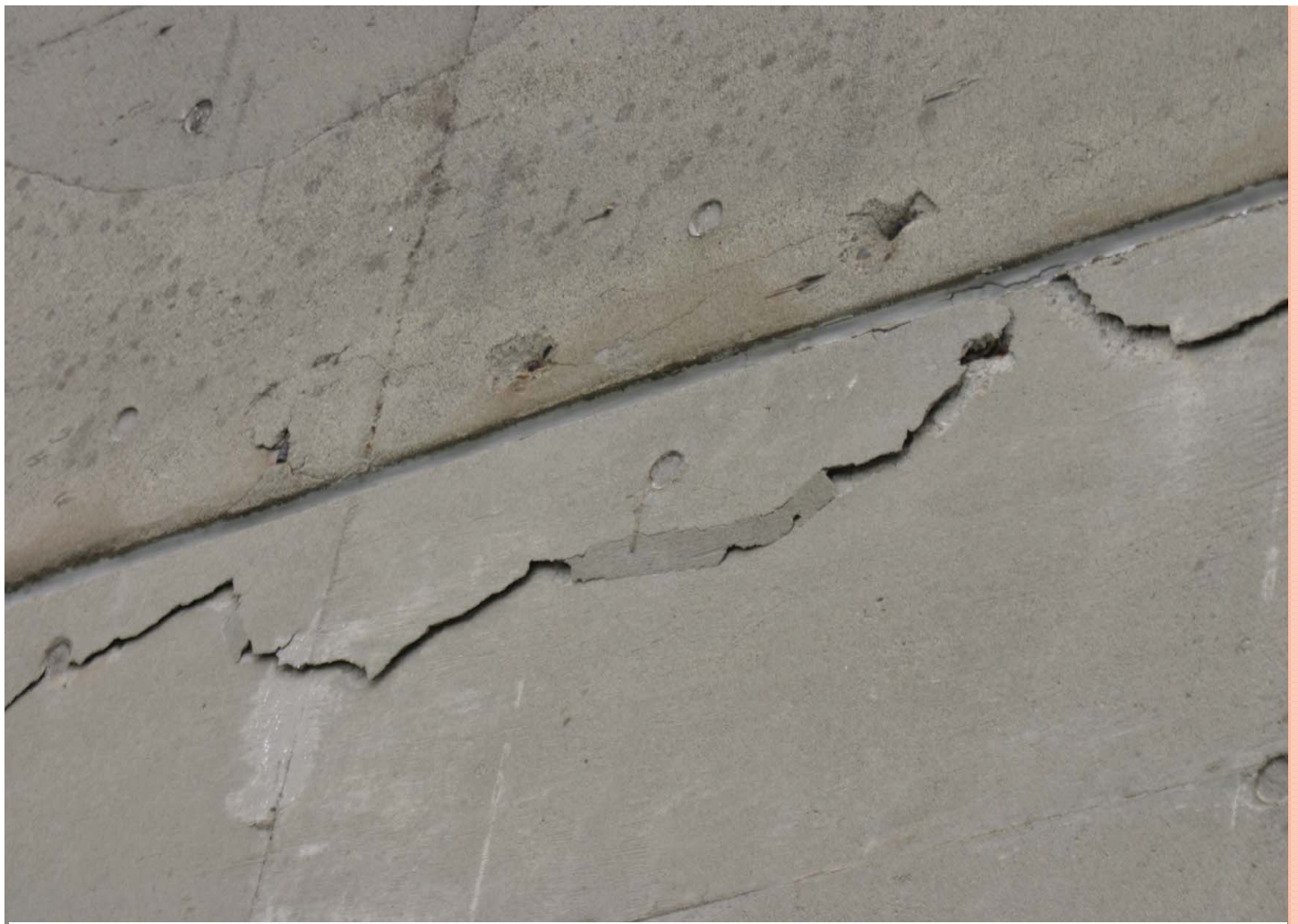
腐食した鉄筋の位置で浮いたコンクリート片
