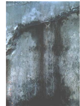
コールドジョイント からの漏水
