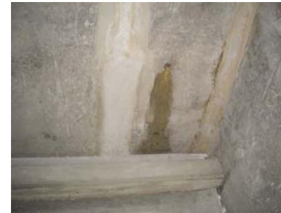
セパレータからの漏水
